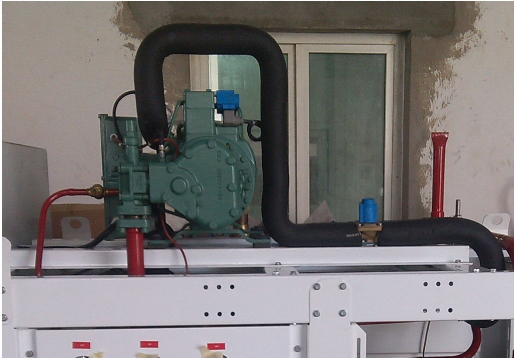
Figure : l'isolation de tuyauterie d'économiseur
