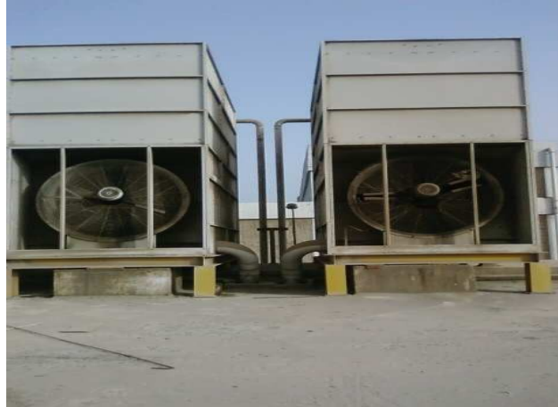
Figure 2.1.2. Vue sur les deux aéré réfrigérants de la station
