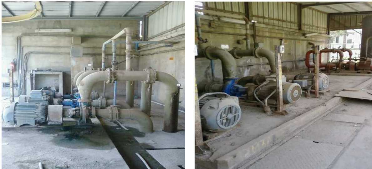
Figure 2.1.1. Pompes de distribution eau industrielle
