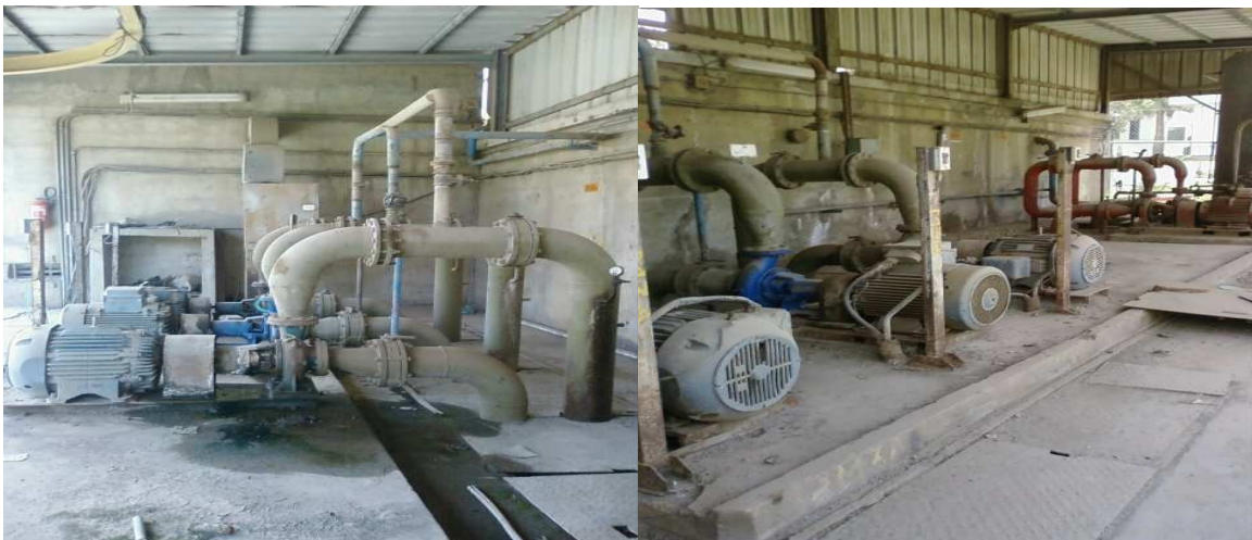
Figure 2.1.3. Pompes de retour eau industrielle
