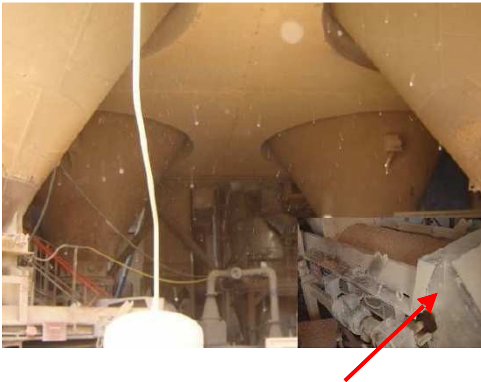
Figure 1.2.3. Trémies de matière première + doseur alimentant La trémie centrale puis broyeur.
