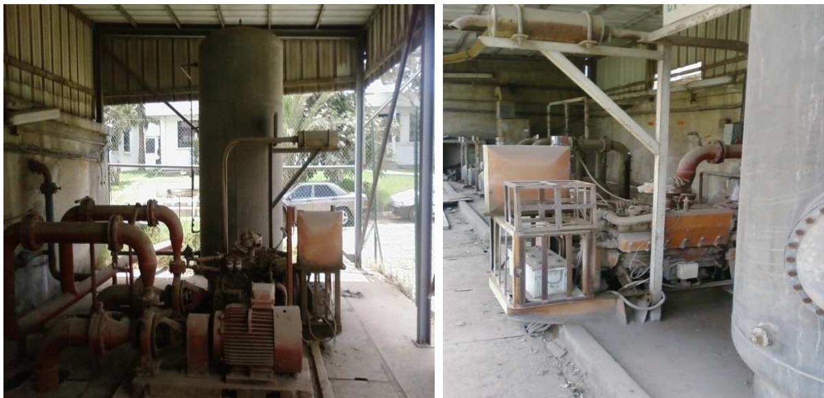
Figure 2.1.5. Pompe de distribution incendie
