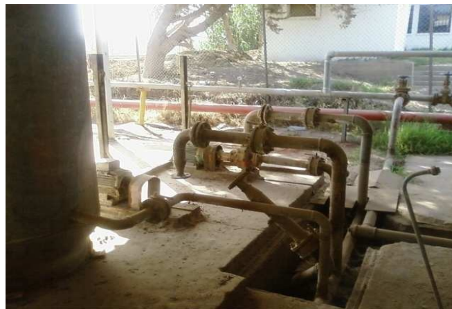
Figure 2.1.4. Pompes de traitement eau potable
